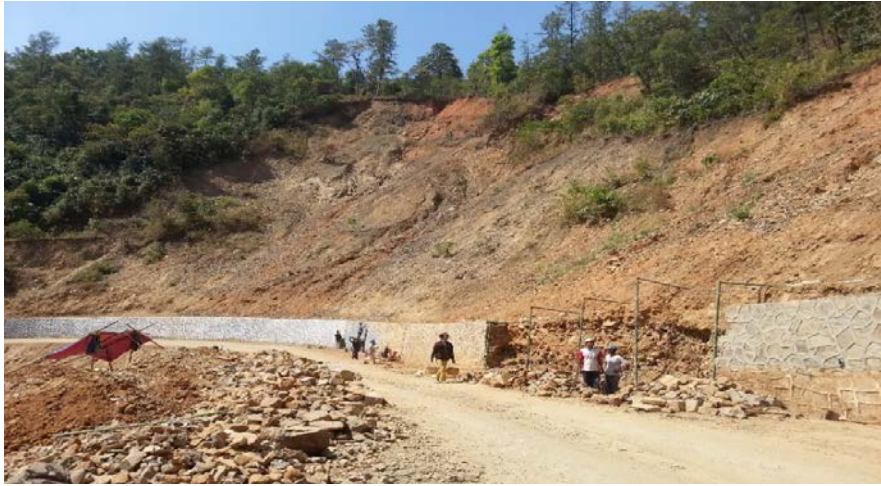
မြေပြိုမှုကို ထိန်းချုပ်ရန် တောင်နံရံကာခြင်း၊ ယင်းတောင်နံရံမှာ ရေနုတ်မြောင်းနှင့် အခြားသော တုန့်ပြန်ဆောင်ရွက်ရမည့် နည်းလမ်းများ ထည့်သွင်းအကောင်အထည်ဖော်ထားသဖြင့် ရေရှည်မခံပါ။ (ဟားခါး - ဂန့်ဂေါ ကားလမ်း)
